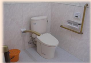
広いトイレスペース
